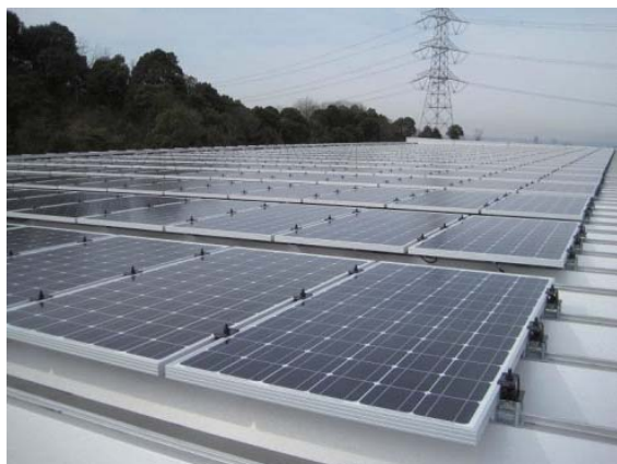
南向きの屋根前面に 315 枚の太陽光パネルを設置。 自社の約 1/3 の電力を賄っています。
